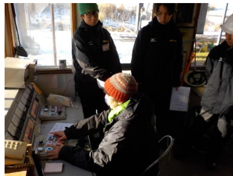
令和5年11月19日（運転盤取扱い）
