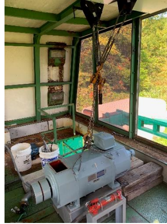
(OH 済み主原動機機械室据付)
